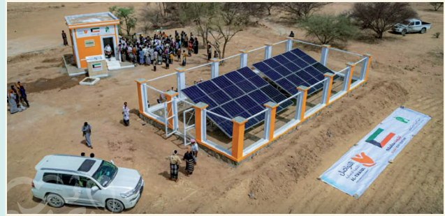
بئر مياه مزودة بأنظمة الطاقة الشمسية
