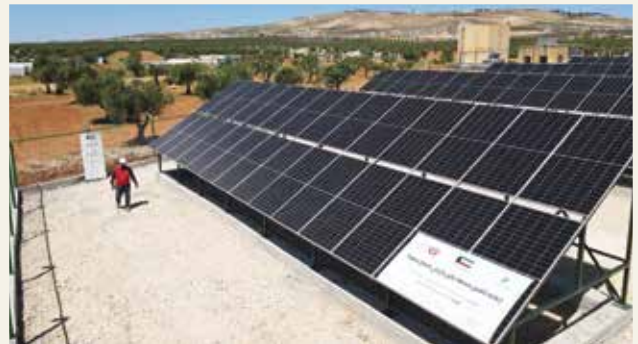
■ منظومة شمسية لتشغيل المحطة
